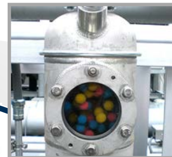
ボール式熱交換器 自動洗浄装置
