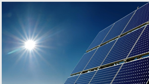
太陽光パネル
