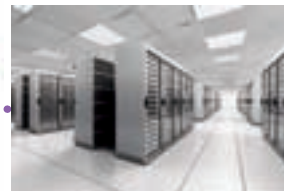
データセンター
