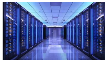
データセンター
